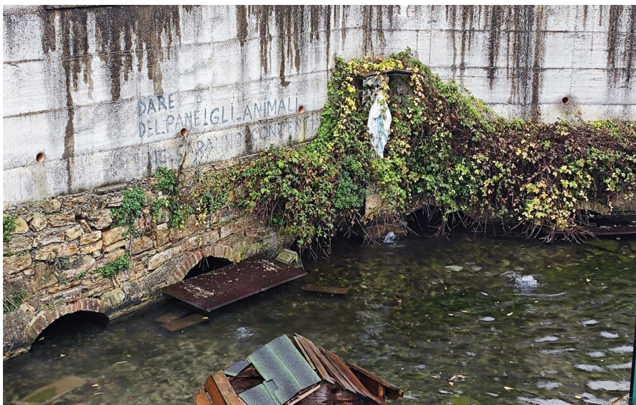
Scatti fotografici relativi alla prima testa del Vaso "Fiume di Cossirano" in fregio alla SP20. La sopraelevazione del parapetto di cemento sopra la storica muratura finestrata di pietra ne ha stravolto l'immagine. Anche in questo caso si assiste all'introduzione di animali, ricoveri, reti.
